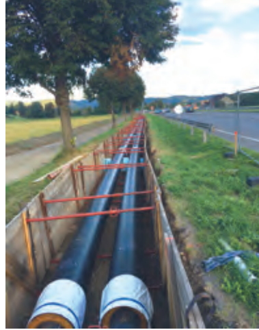
5.400 Kilometer Fernwärmeleitungen sind in Österreich installiert, hier ist der neue Anschluss der Papierfabrik Sappi Gratkorn in Graz zu sehen
