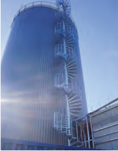
Großtechnischer Fernwärmespeicher zum Ausgleich für fluktuierende Einspeisung
